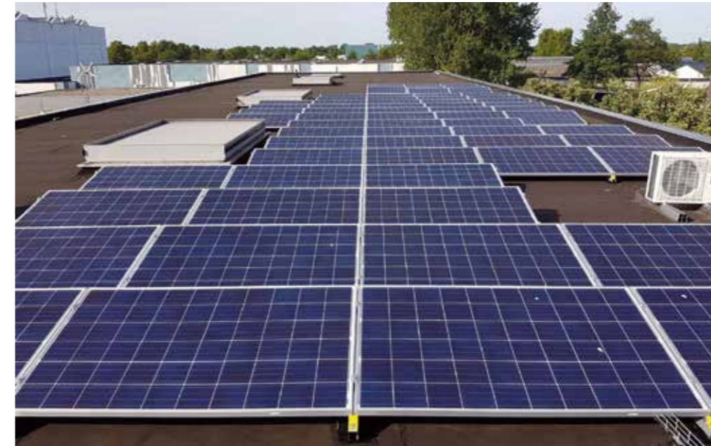
Zonnepanelen op bedrijventerreinen in Hoorn gerealiseerd door de Energiecoöperatie West-Friesland.
